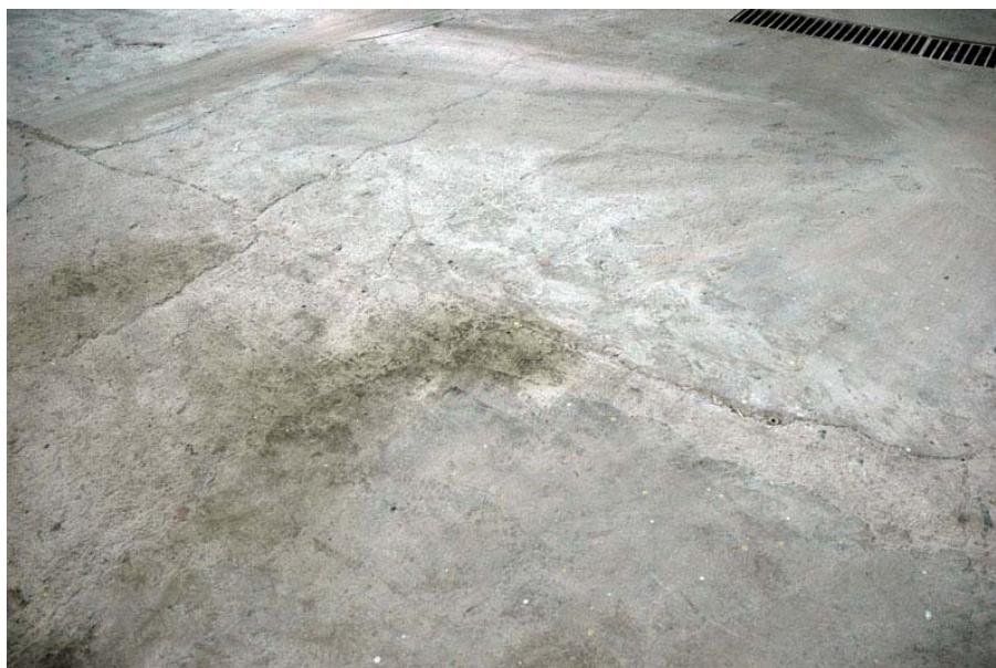
Fot.13 – Uszkodzenia posadzki w strefie środkowej pomiędzy kanałami głównymi.
