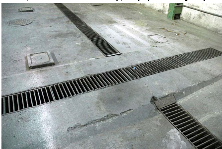
Fot.14 – Uszkodzenia krawędzi konstrukcji kanałów pomocniczych, pęknięcie wzdłuż osi kanału głównego
