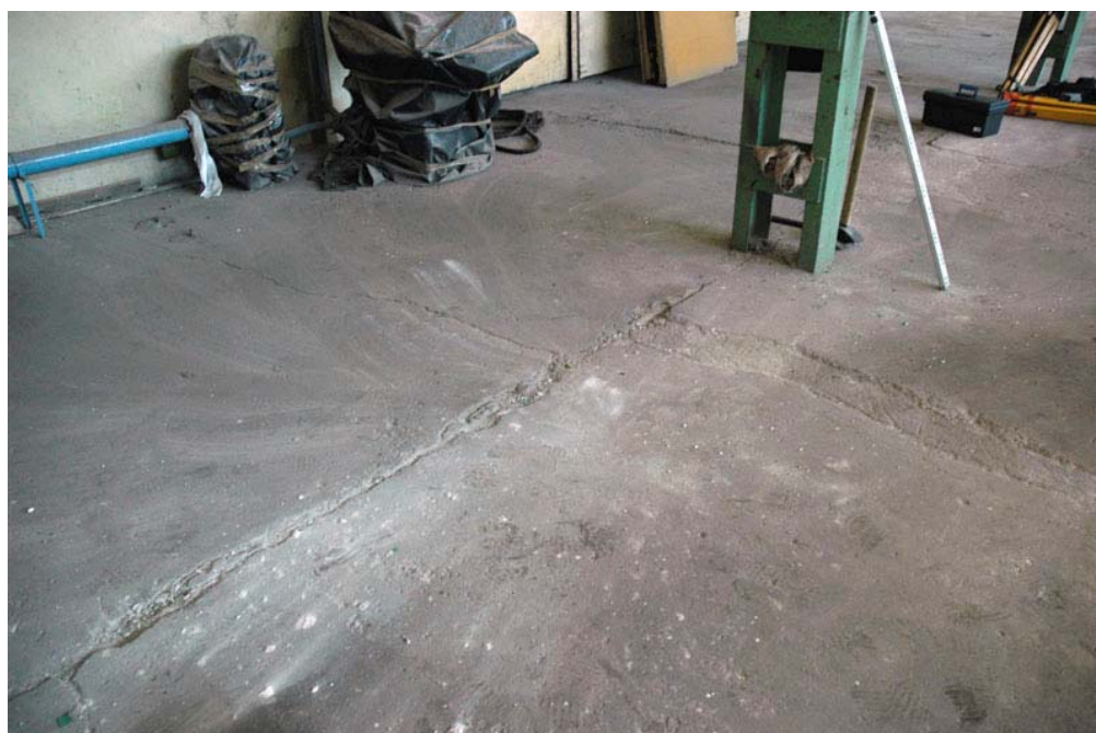
Fot.12 – Uszkodzenia posadzki wzdłuż osi słupów w rejonie ciągu komunikacyjnego (strona północna – nawa niższa)
