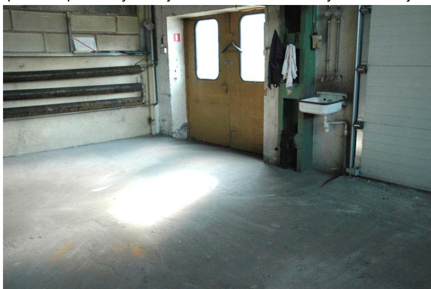
Fot.17 – Ukształtowanie posadzki przy wejściu i przy bramie od strony wschodniej (spadki w przeciwnych kierunkach)
