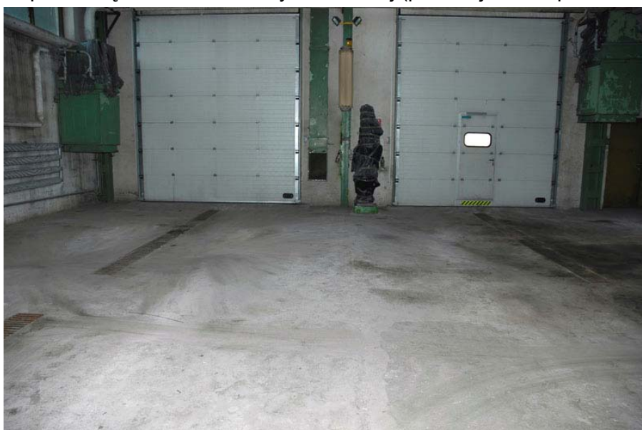
Fot.8 – Widok na bramy zachodnie. Widoczne uszkodzenia posadzki – analogicznie jak na fot. 7
