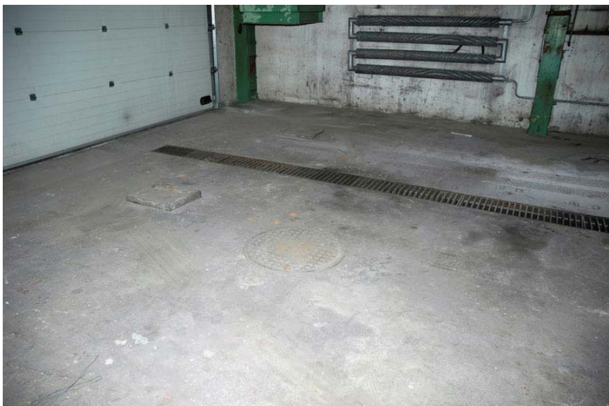
Fot.4 – Studzienka kanalizacji i odwodnienie liniowe w rejonie bramy od strony połudn. – wsch.
