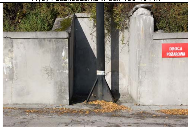
Uszkodzenia w rejonie wnęki pod maszt odgromowy
