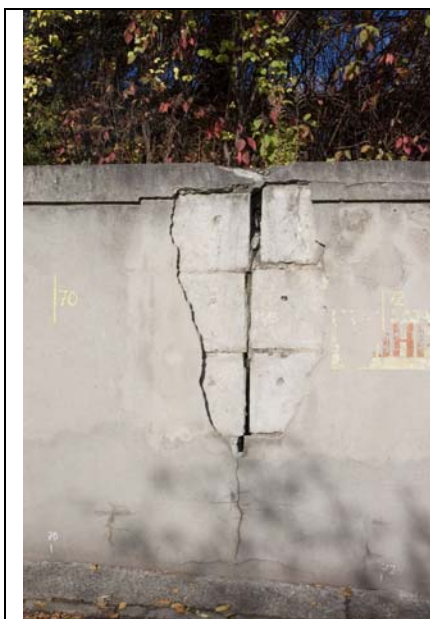
Rysy i uszkodzenia w odł. 70-72 m
