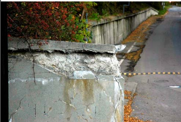
Uszkodzenie ściany w rejonie masztu odgromowego
