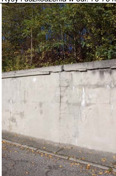
Rysy i uszkodzenia w odł. 106-108 m
