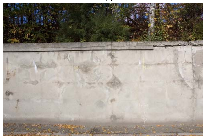
Rysy i uszkodzenia w odł. 98-102 m
