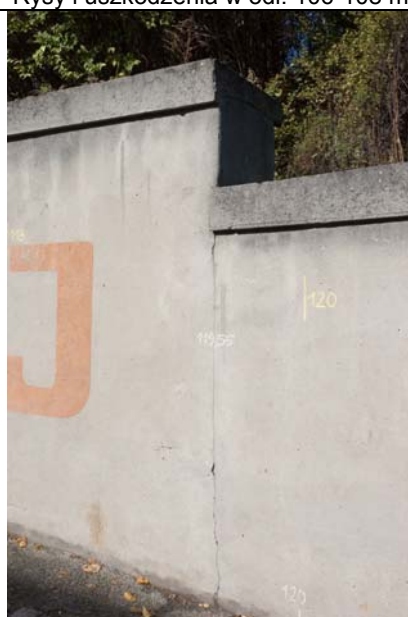
Rysy i uszkodzenia w odł. 118-120 m
