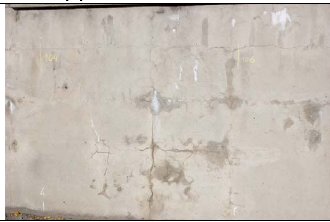
Rysy i uszkodzenia w odł. 104-106 m
