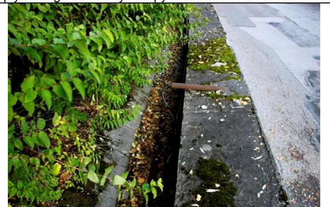
Zanieczyszczenia kanału odpływowego z widokiem na czapę
