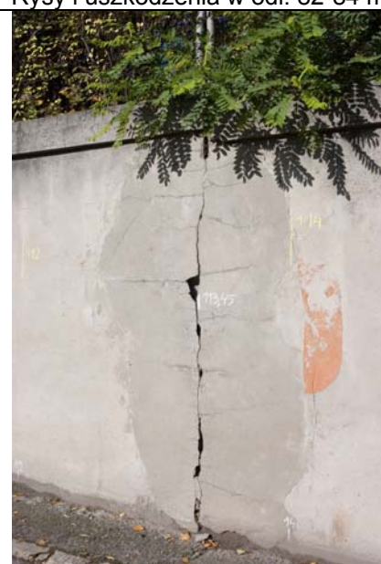
Rysy i uszkodzenia w odł. 112-114 m
