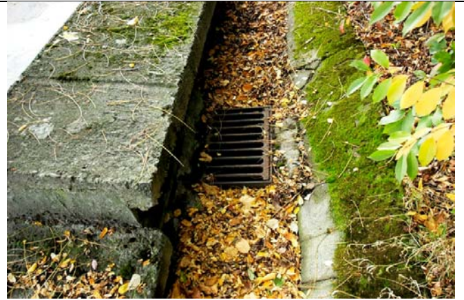
Zanieczyszczenia kanału odpływowego
