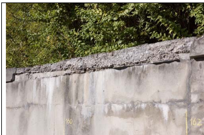
Uszkodzenia czapy w odł. 160 m
