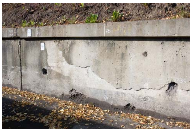
Uszkodzenia powierzchniowe w odl. 73-77 m
