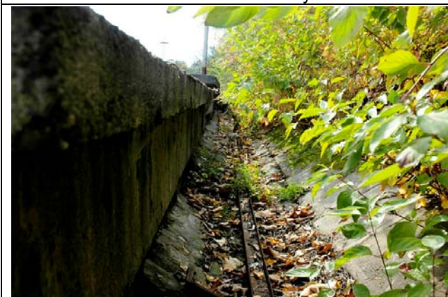
Zanieczyszczenia kanału odpływowego
