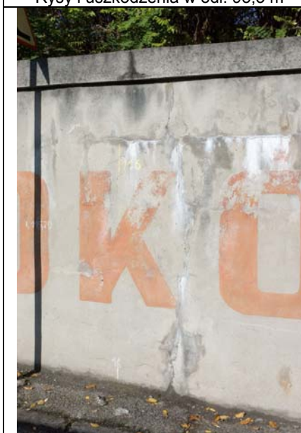
Rysy i uszkodzenia w odł. 116 m
