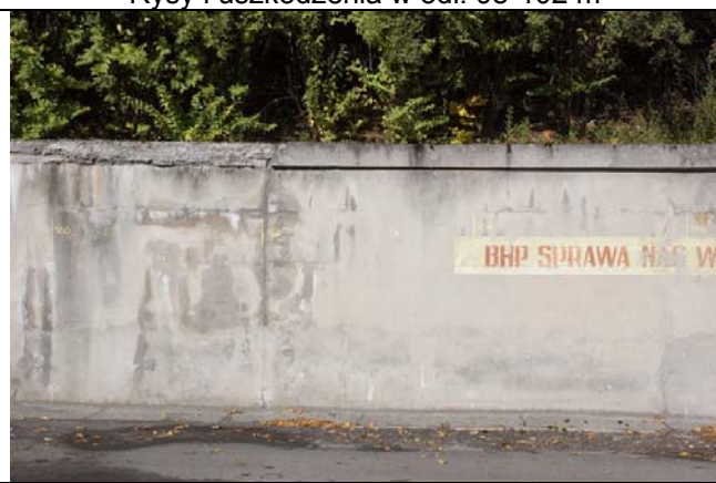
Rysy i uszkodzenia w odł. 160-166 m
