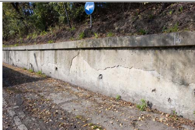
Uszkodzenia powierzchniowe w odl. 78-90 m
