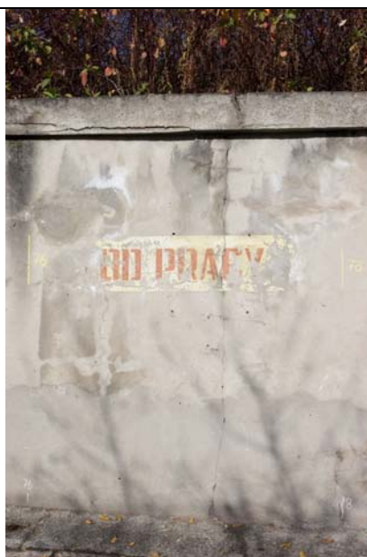
Rysy i uszkodzenia w odł. 76-78 m
