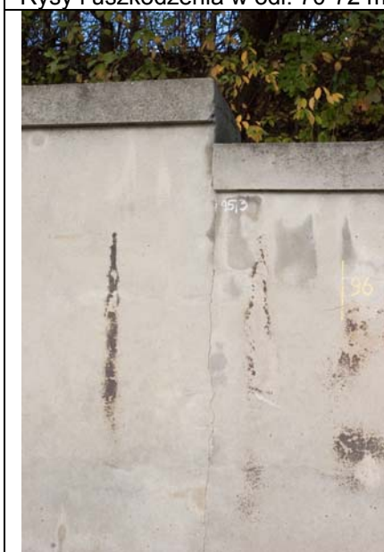
Rysy i uszkodzenia w odł. 95,3 m
