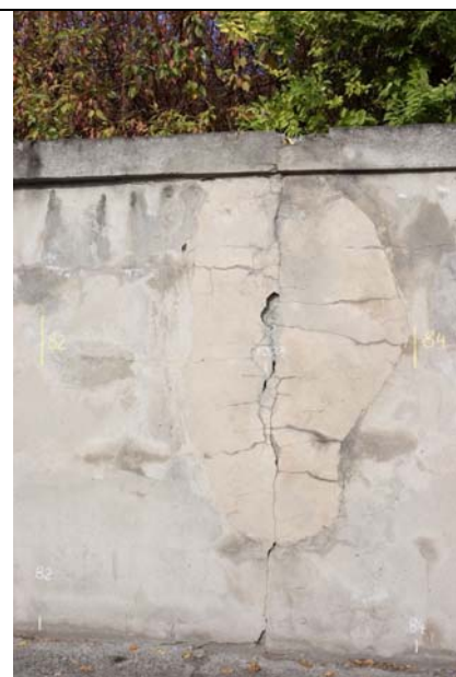
Rysy i uszkodzenia w odł. 82-84 m
