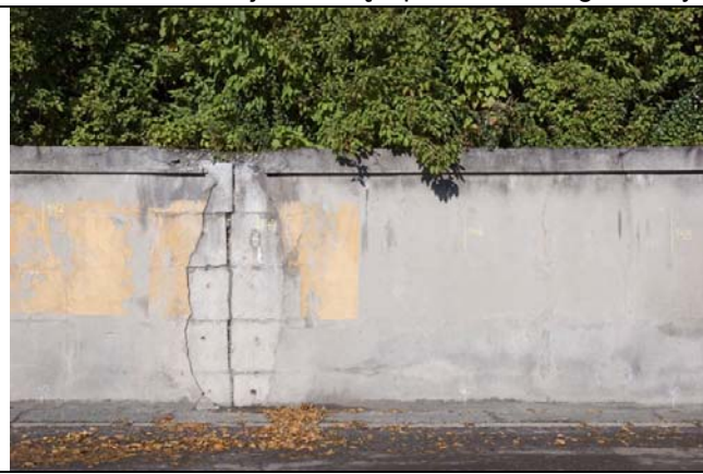
Uszkodzenia w odł. 142-147 m
