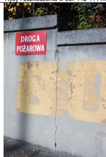
Rysy i uszkodzenia w odł. 130-132 m
