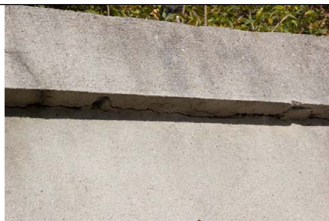
Uszkodzenia czapy pęknięcie na styku ze ścianą
