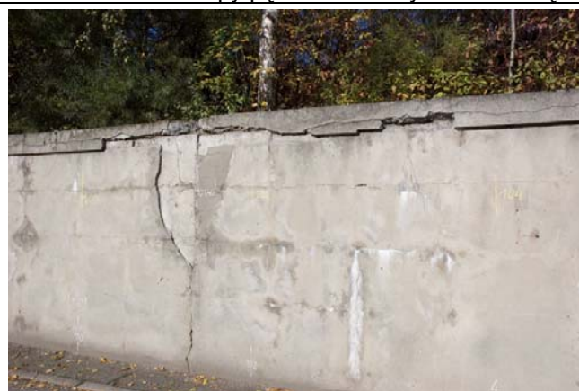
Rysy i uszkodzenia w odł. 100-104 m
