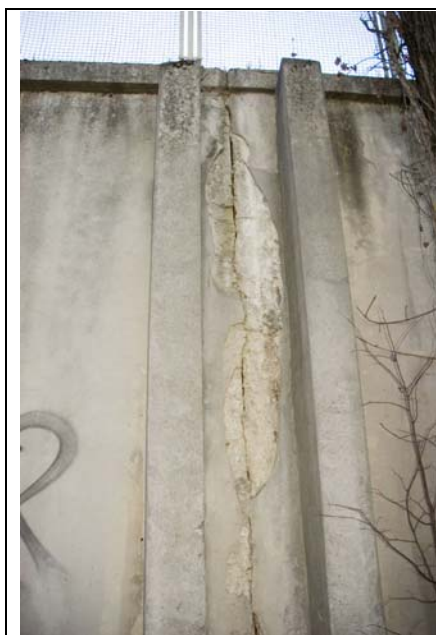
Fot. 13 – Odpadający tynk w miejscu dylatacji
