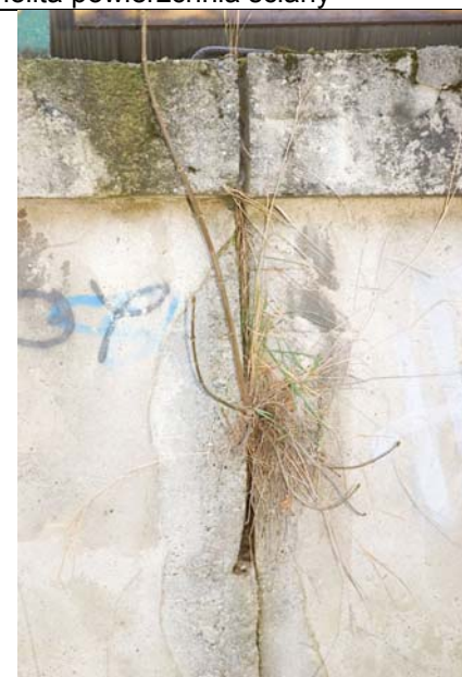
Fot. 27 – Rośliność przerastająca przez dylatację
