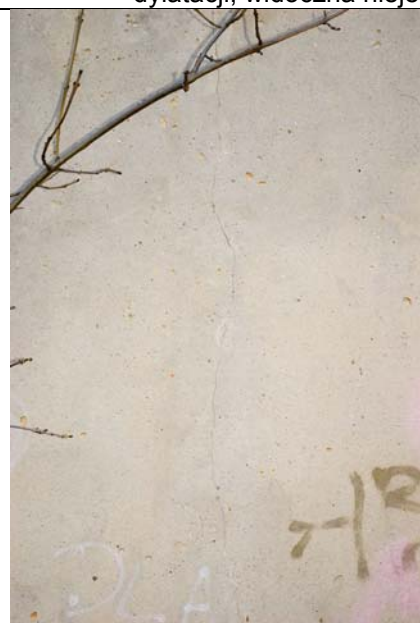
Fot. 26 – Rysa na powierzchni tynku
