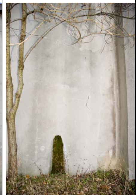
Fot.12 – Zarośnięty otwór odwodnienia
