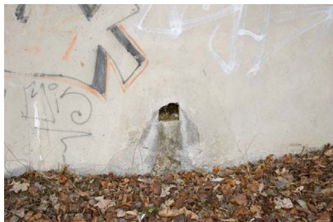
Fot. 29 – Zawilgocenie ściany poniżej otworu odwodnienia
