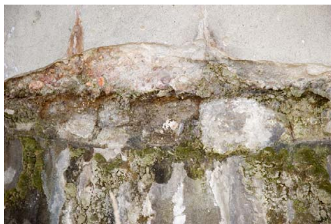
Fot. 19 – Grzyb na powierzchni ściany, szczegół fot. 18
