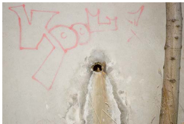
Fot.17 – Zawilgocenia powierzchni ściany poniżej otworu odwodnienia
