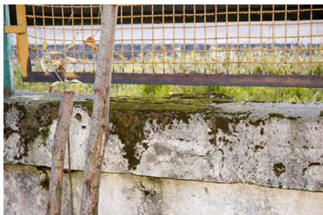
Fot. 28 – Porośnięta mchem korona ściany wraz z widoczną korozją elementu ogrodzenia
