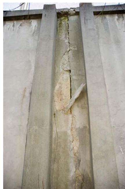
Fot. 11 – Odpadający tynk w miejscu dylatacji
