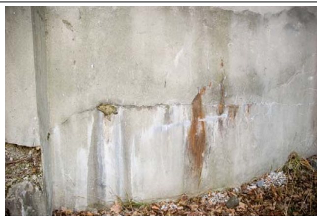
Fot. 21 – Brak otuliny zbrojenia żebra i uszkodzenia na powierzchni ściany
