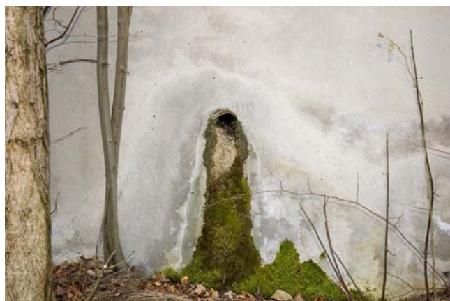
Fot.16 – Zarośnięty otwór odwodnienia, zawilgocenie ściany i porastający mech
