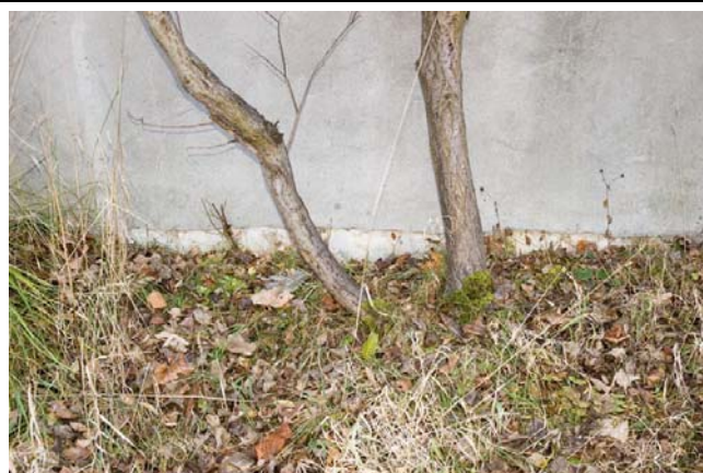
Fot. 31 Porastające krzewy tuż przy ścianie
