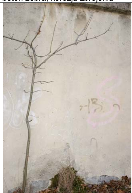
Fot. 25 – Zawilgocenie poniżej odwodnienia zasypki ściany
