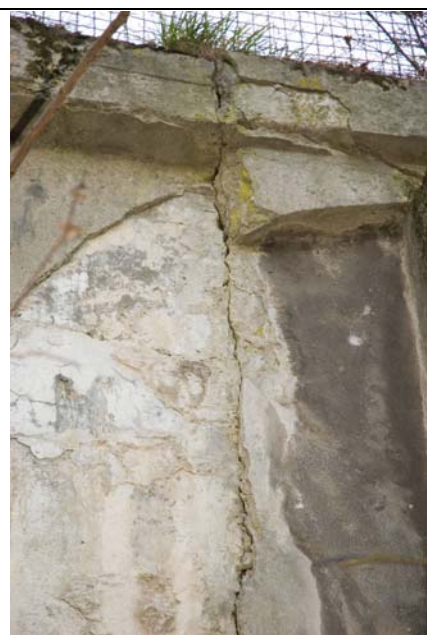
Fot. 15 – Odpadający tynk w miejscu dylatacji, szczegół fot 14
