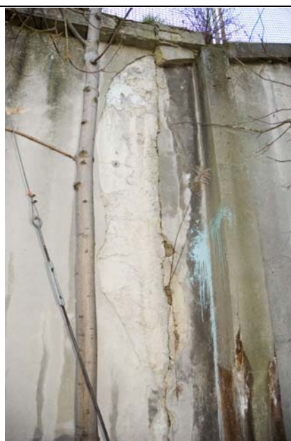
Fot. 14 – Odpadający tynk w miejscu dylatacji, korozja betonu żebra poprzecznego
