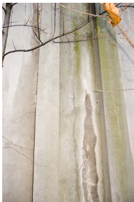
Fot. 10 - Rysa w miejscu styku segmentu 2 i 3
