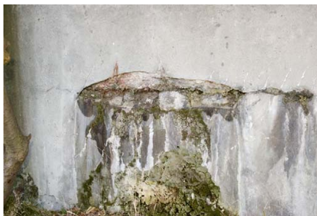
Fot. 18 – Uszkodzony i zmurszały beton w miejscu nadbudowy ściany, poniżej widoczny grzyb
