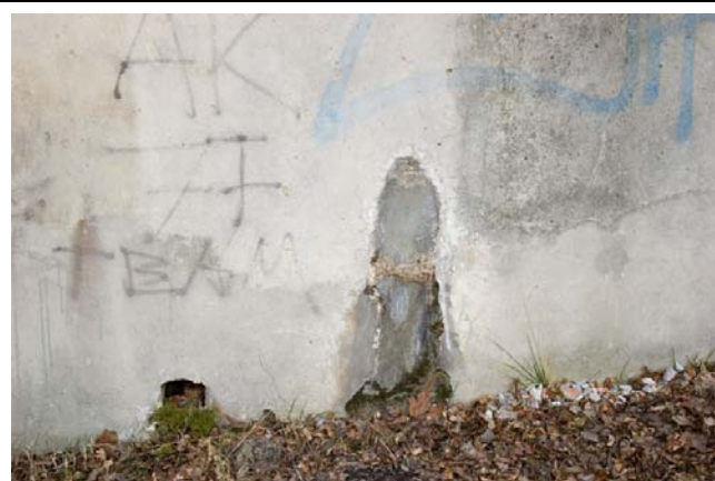
Fot. 30 – Zanieczyszczony otwór odwodnienia
