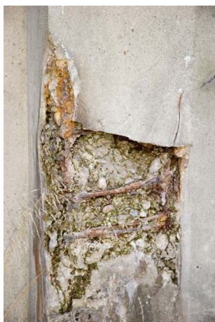
Fot.22 – Odspojony i skorodowany beton żebra, korozja zbrojenia
