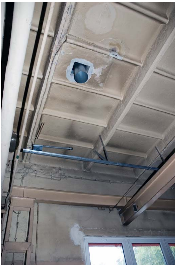
Fot.10 – Wyprowadzenie kanału wentylacyjnego przez stropodach w paśmie płyt w rejonie bramy wjazdowej.
