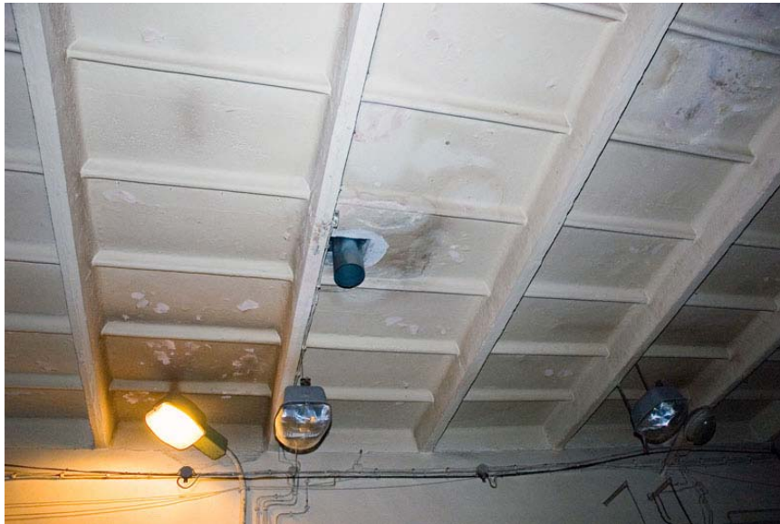
Fot.7 – Wyprowadzenie kanału wentylacyjnego przez stropodach. W prawym górnym rogu widoczne wykwyty powstałe na wskutek nieszczelności pokrycia.
