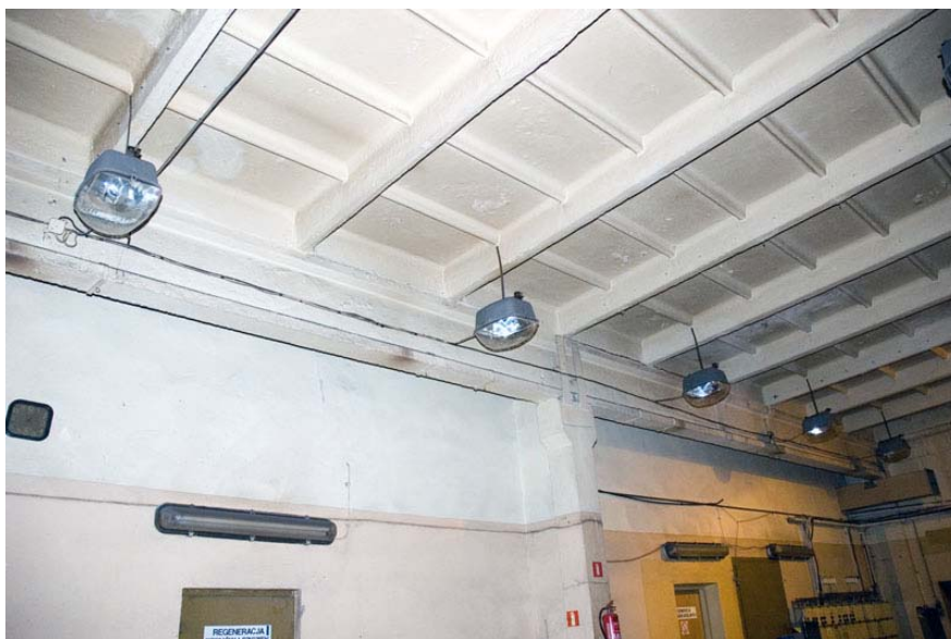
Fot.8 – Oparcie płyt na belce prefabrykowanej (widok od strony ciągu naprawczego).
